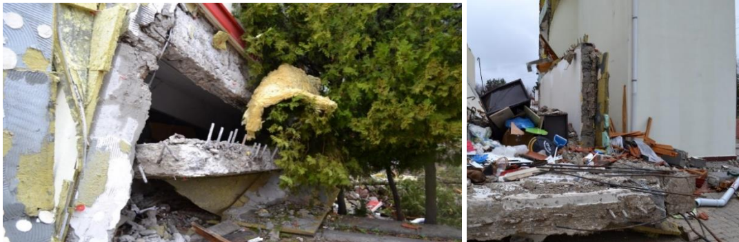
Görsel 1. Güçlendirilmiş Binalarda Ankraj Yetersizliği Nedeniyle Devrilen Perdeler
